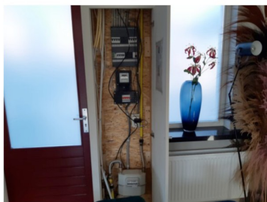
Meterkast met eigen gasmeter
